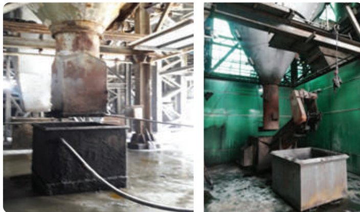
ภาพ ระบบแยกฝุ่นออกจากหอลดอุณหภูมิ (Evaporation cooling tower) ระบบเดิม
